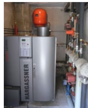
Chaudière bois granulés
