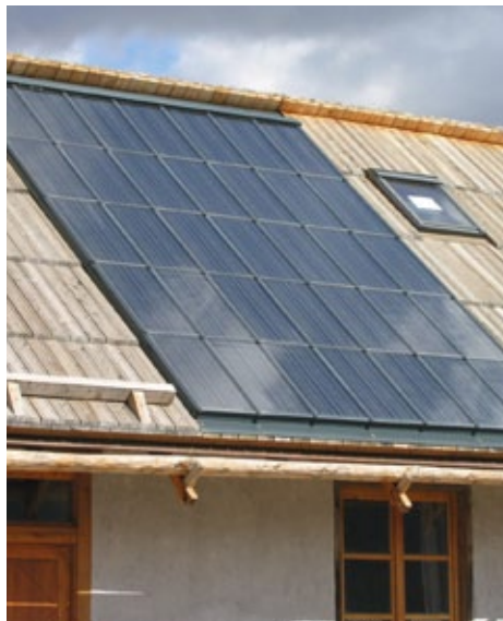
Installation solaire thermique (05)
